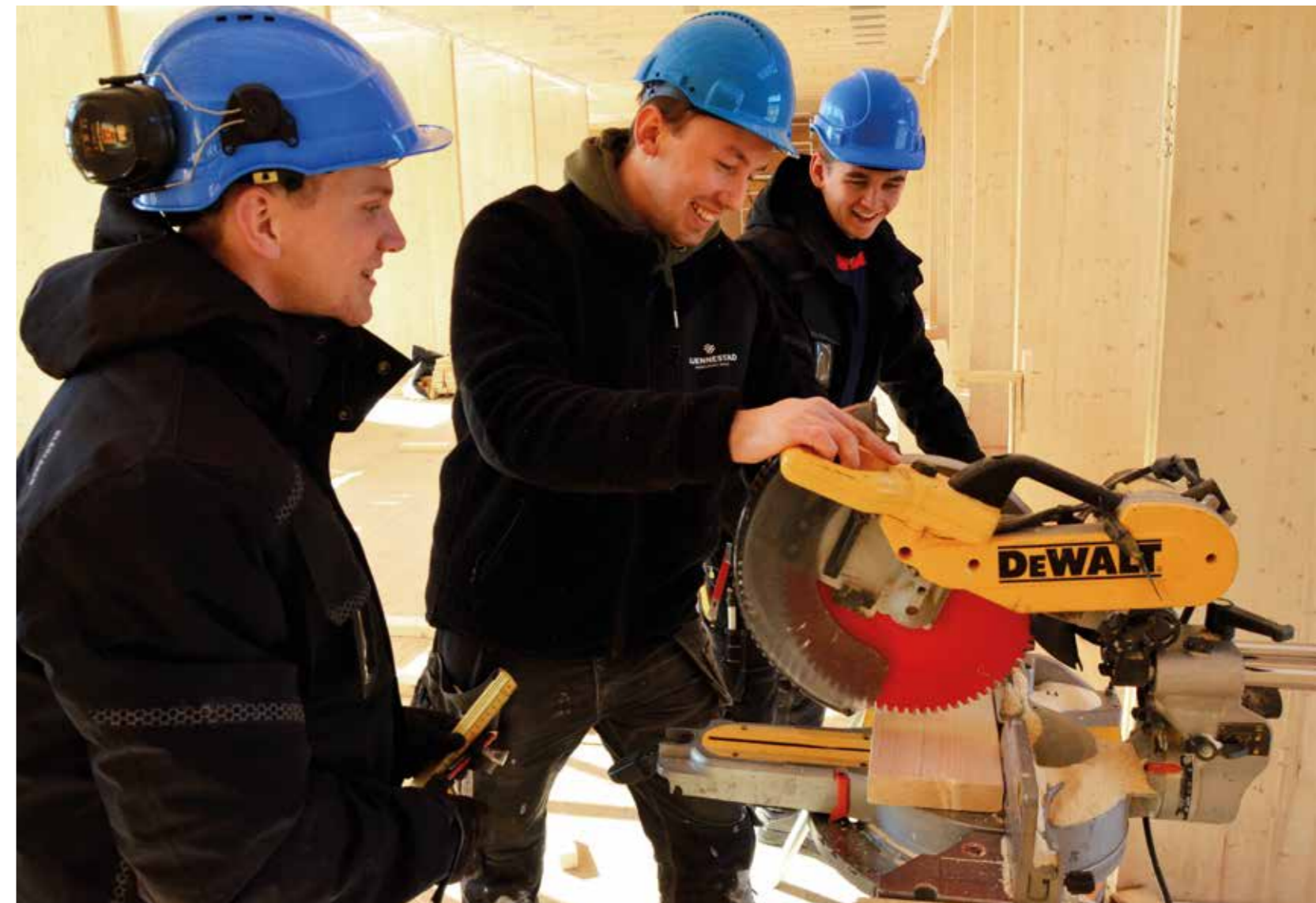
Ivar Grødem, Henrik H Børresen og Sander Aas er tre av Gjennestad-elevene som er med og bygger skolens nye massivtrehus.
